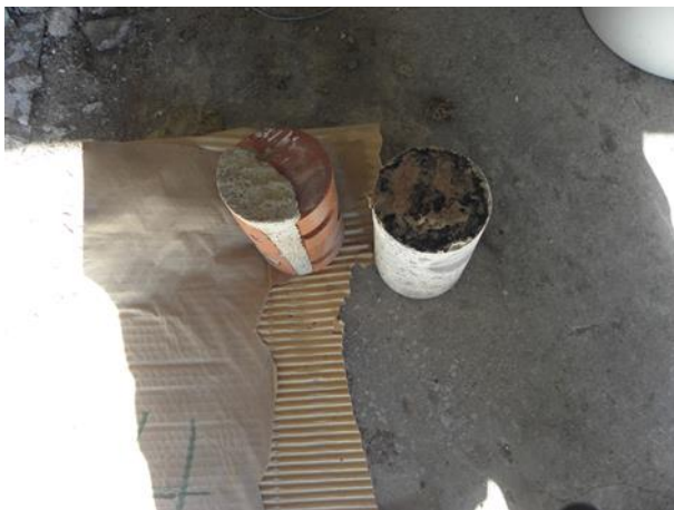
Kuva 9.1 Sokkelin pikisively, ei ylitä PAH-pitoisuuden raja-arvoa.
